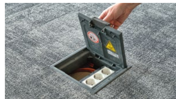
Bodentanks in den Räumen
